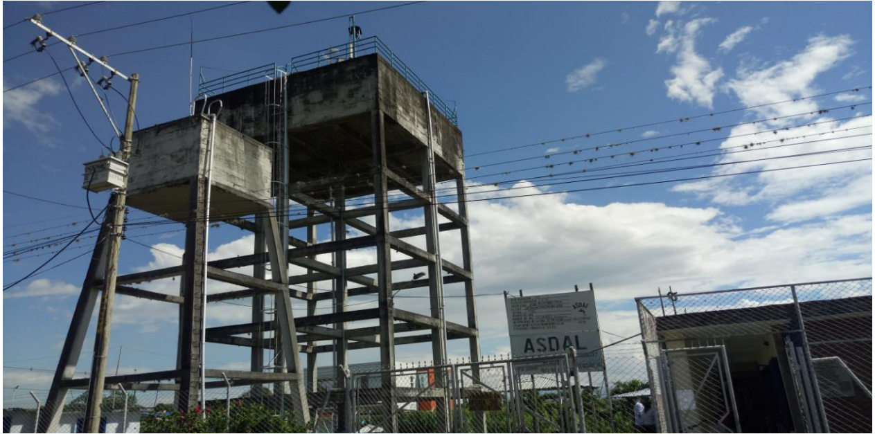
Foto Vallecaucana de Aguas / Acueducto de Tres Esquinas-Tuluá
